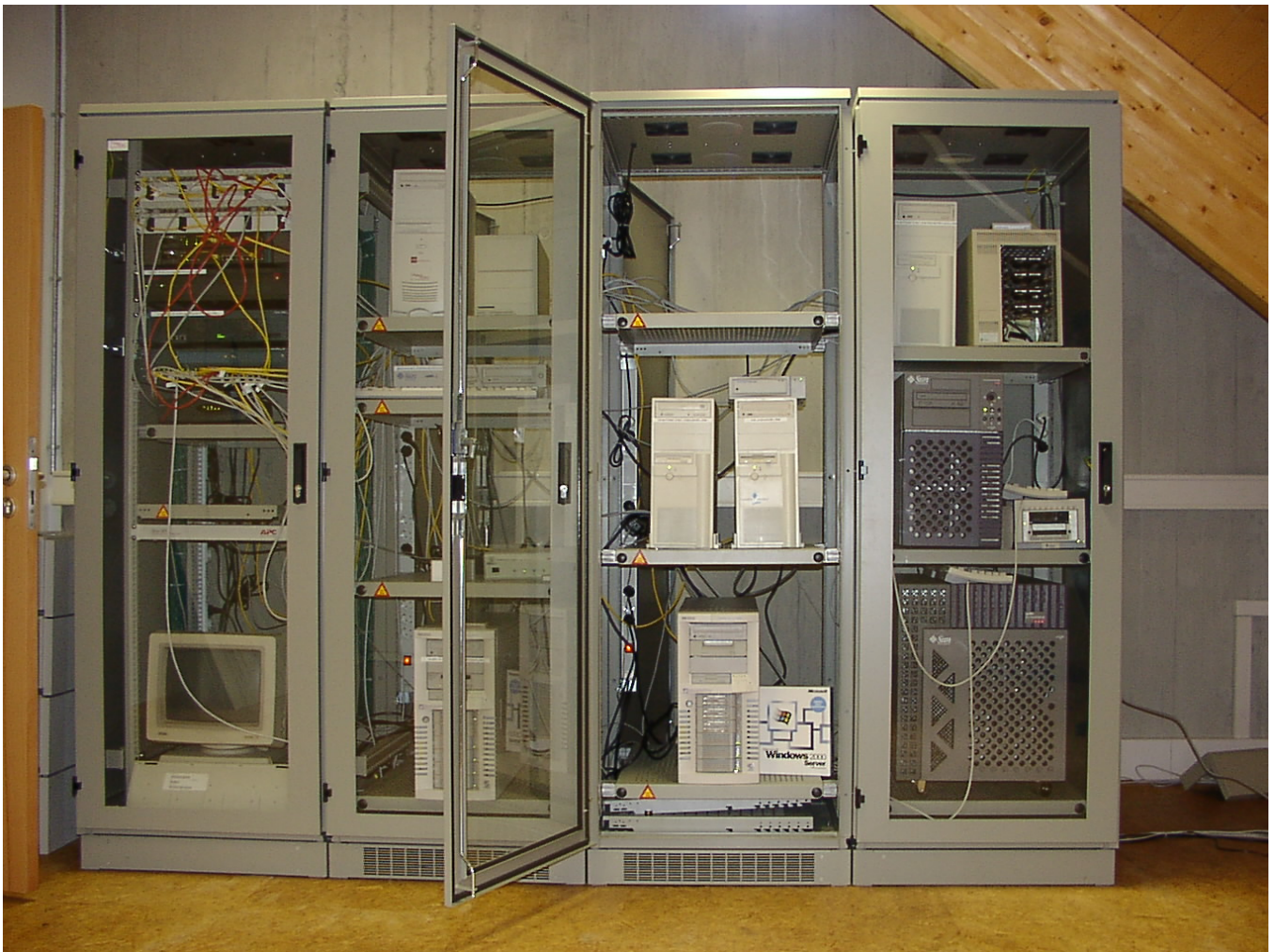
Der Server-Schrank des Bürgernetzes Neuburg-Schrobenhausen im „Haus im Moos“.
